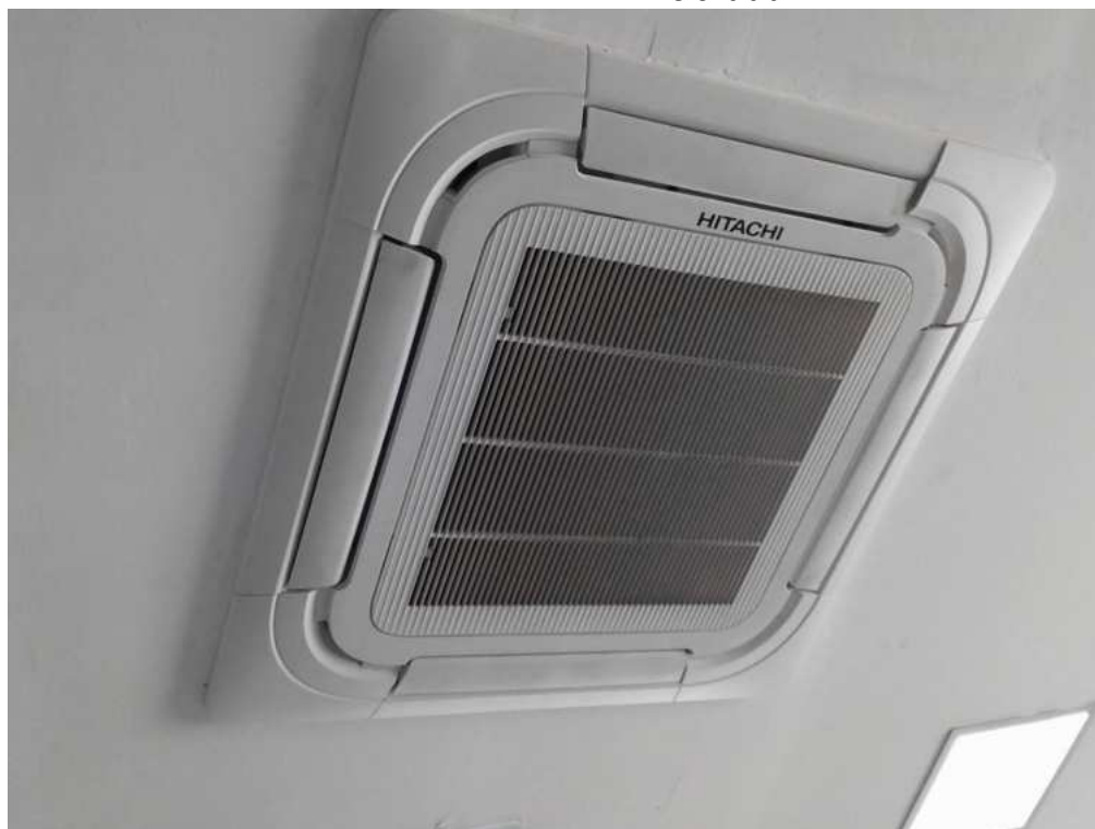
Ar Condicionado Hitachi 56.000 btus
