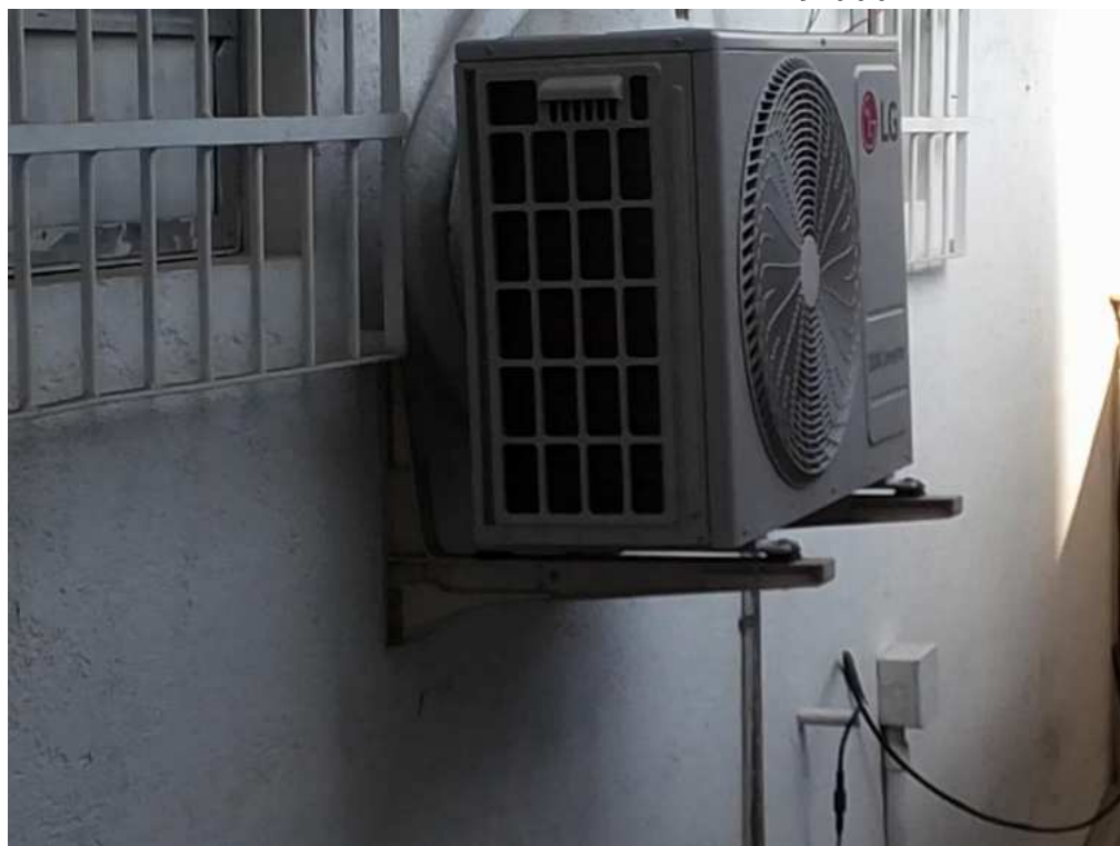
Condensadoras do Ar Condicionado 19.000 btus
